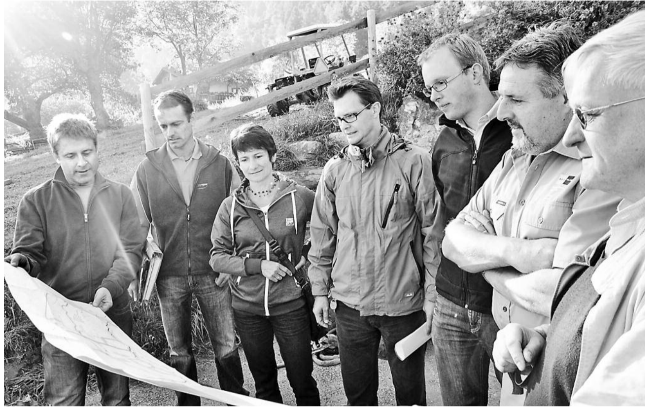
Im Zeitplan: (von links) Reto Zehnder, Josef Zehnder AG, Rainer Überle, Gombau, Stadträtin Lucia Näfen, Stadttingenieur Björn Wyss, Jonas Kalbermatten, EnBAG, Brunnenmeister Norbert Gemmet und Projektleiter Martin Bodenmann. FOTO WB
