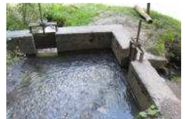
Répartiteur d'eau sur le bisse de Savièse
