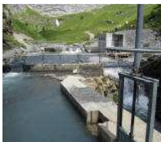
Prise du bisse de Tsittoret, sur la Tièche, dont les eaux (à droite) prendront en aval le nom de Raspille
